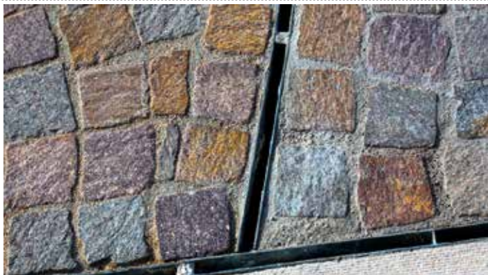
1 FOTO DELLA GRIGLIA A FESSURA
